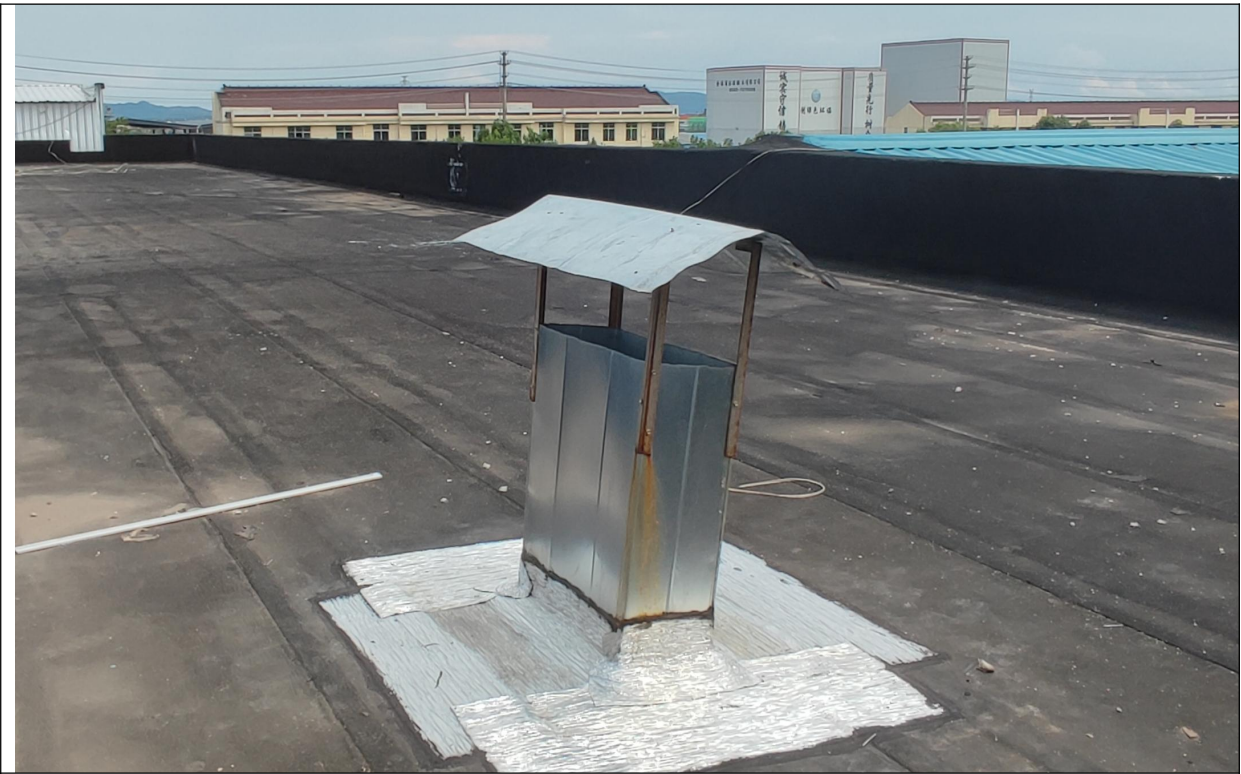
天然气燃烧烟气排气筒（DA003）
