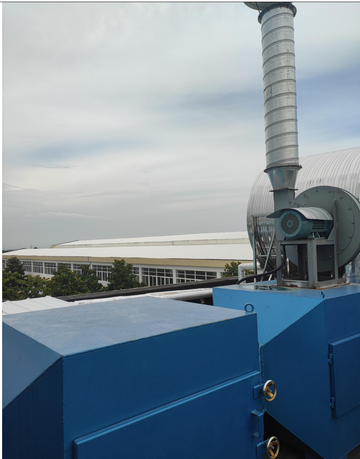
1 套两级活性炭吸附装置+有机废气排气筒（DA001）
