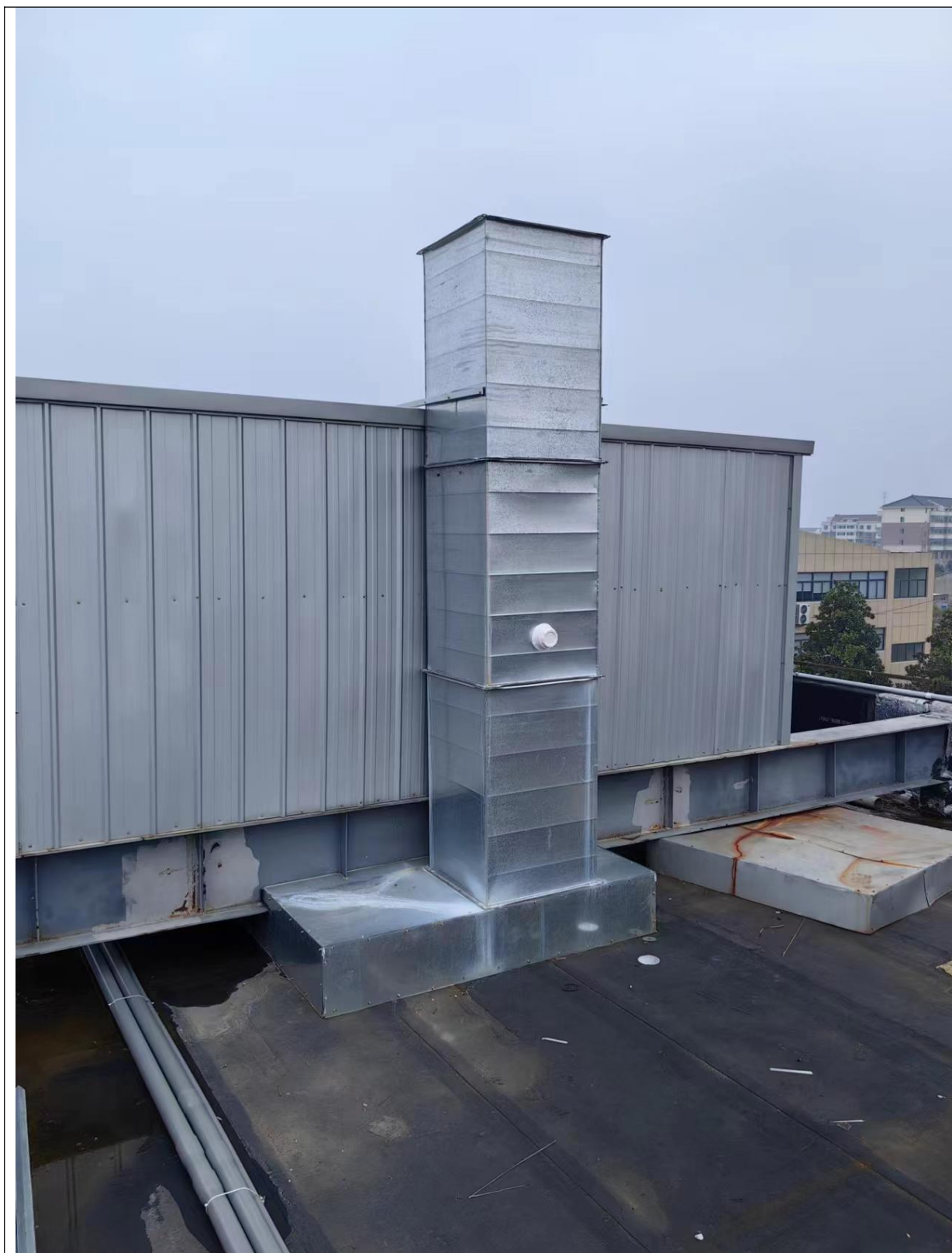
天然气燃烧烟气排气筒（DA002）
