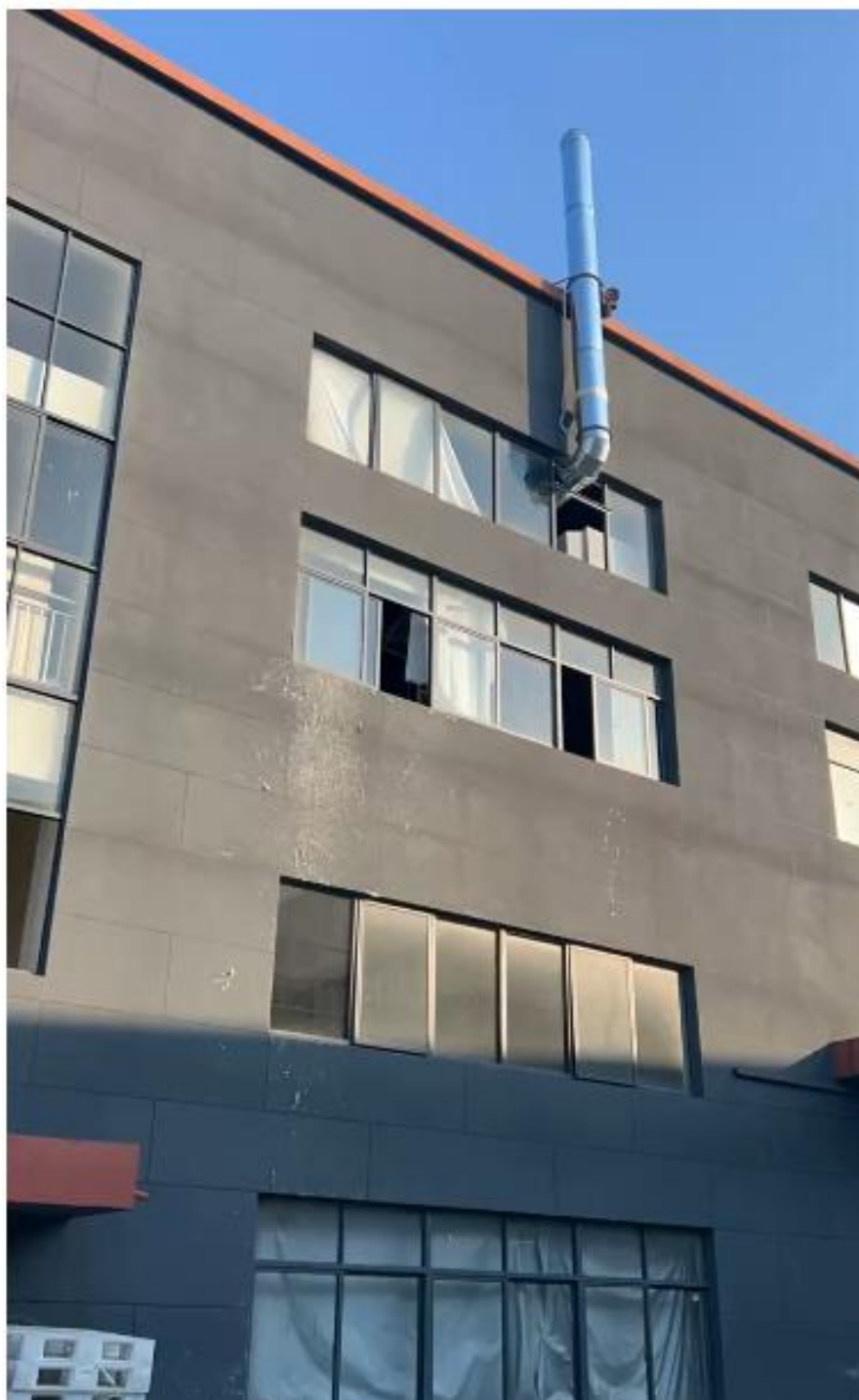
1 套静电油雾净化器+两级活性炭吸附装置+1 根 15 米高排气筒
