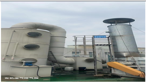
有机废气处理设施
