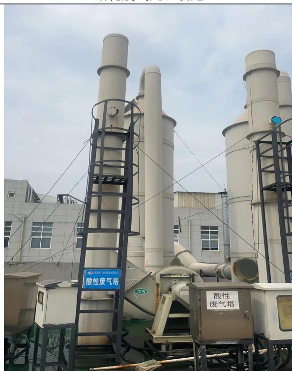
酸性废气处理设施
