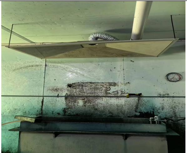
洗网水浸泡废气收集
