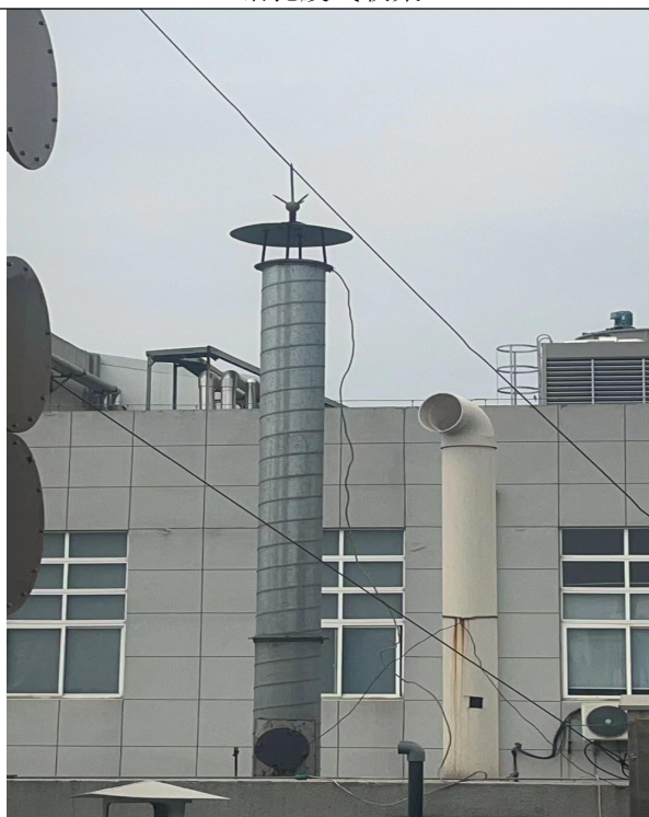
钻孔废气排气筒
