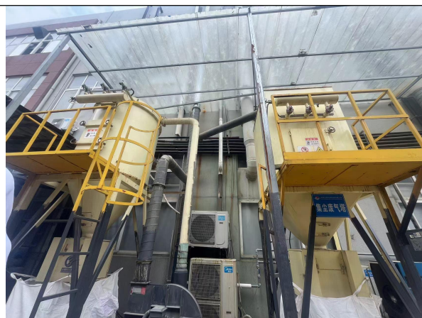
钻孔废气处理设施
