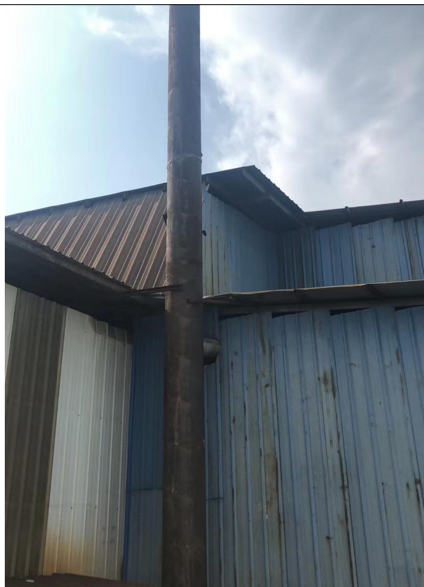
落砂及焙烧废气排气筒
