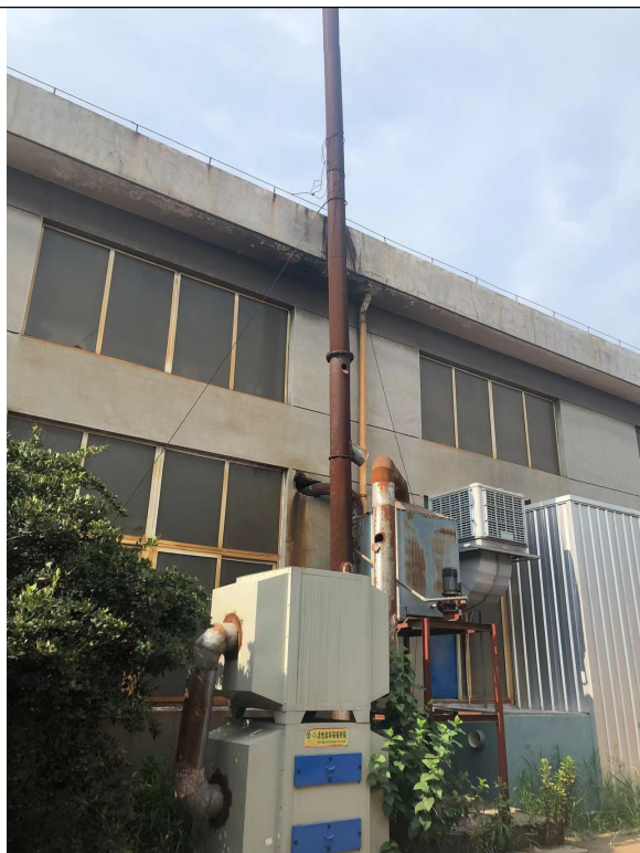
固化废气排气筒
