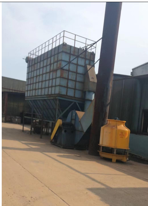
浇注废气排气筒
