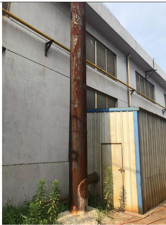
喷塑废气排气筒
