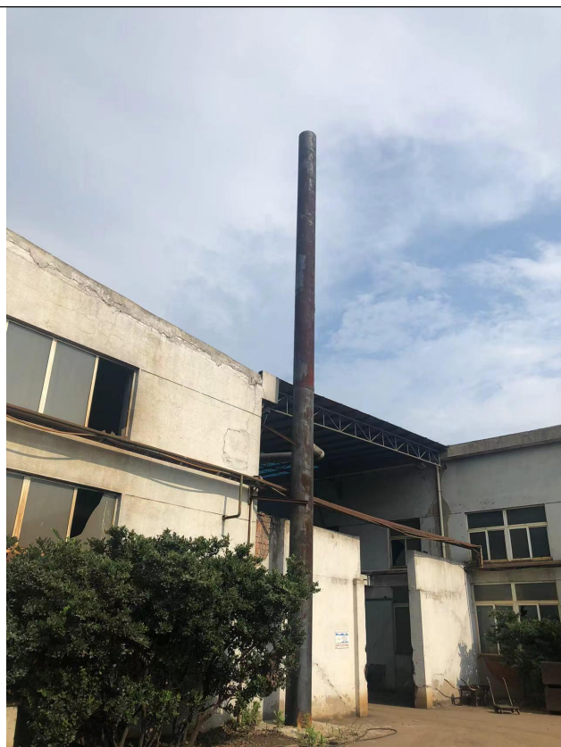
抛丸废气排气筒
