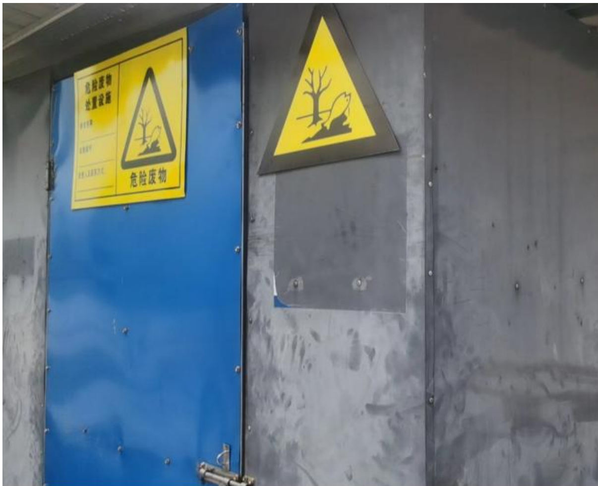
图 4.2-2 本项目危废暂存间设置情况
