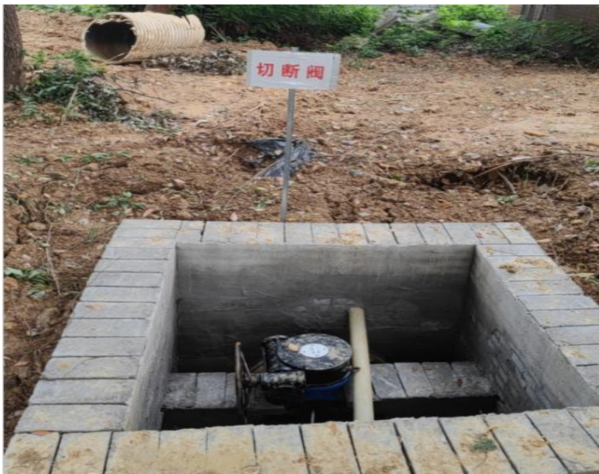
图 4.2-5 应急事故池配套建设的切断阀
