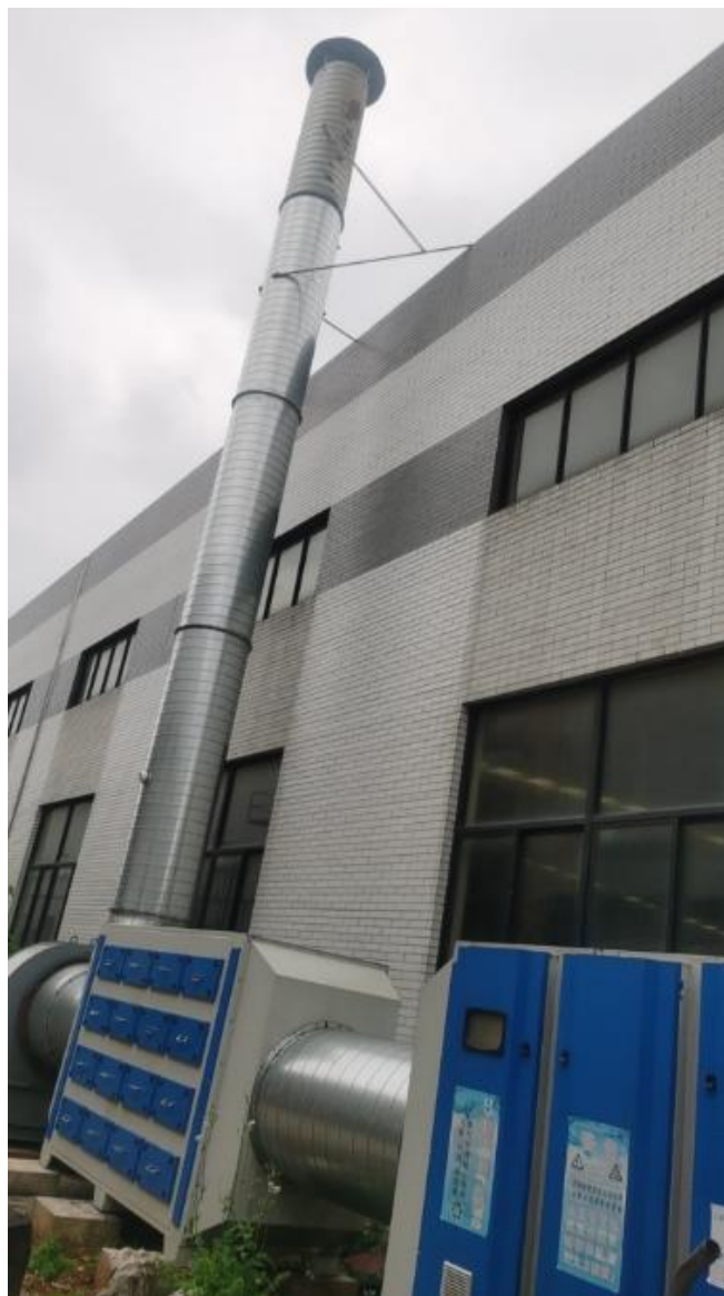
紫外光高级氧化装置+活性炭吸附装置+排气筒
