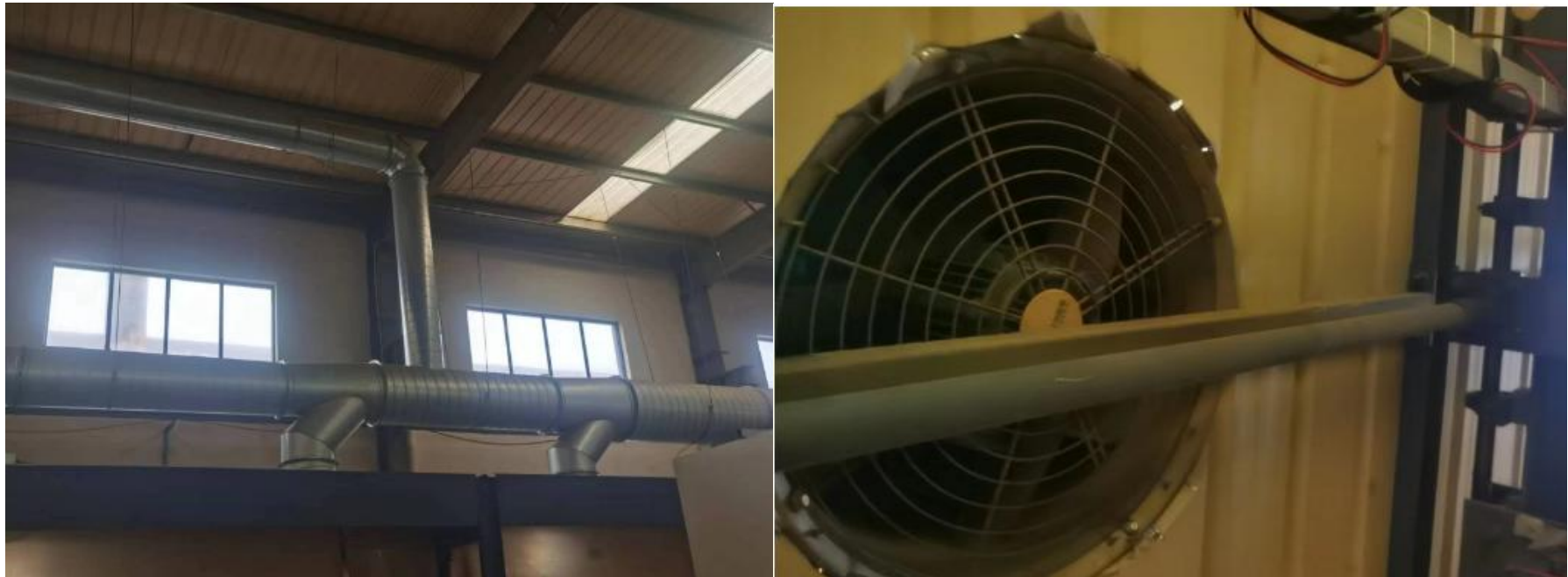
发泡废气收集管道及抽风口
