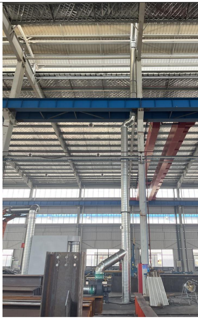
5#车间切割烟尘收集措施
