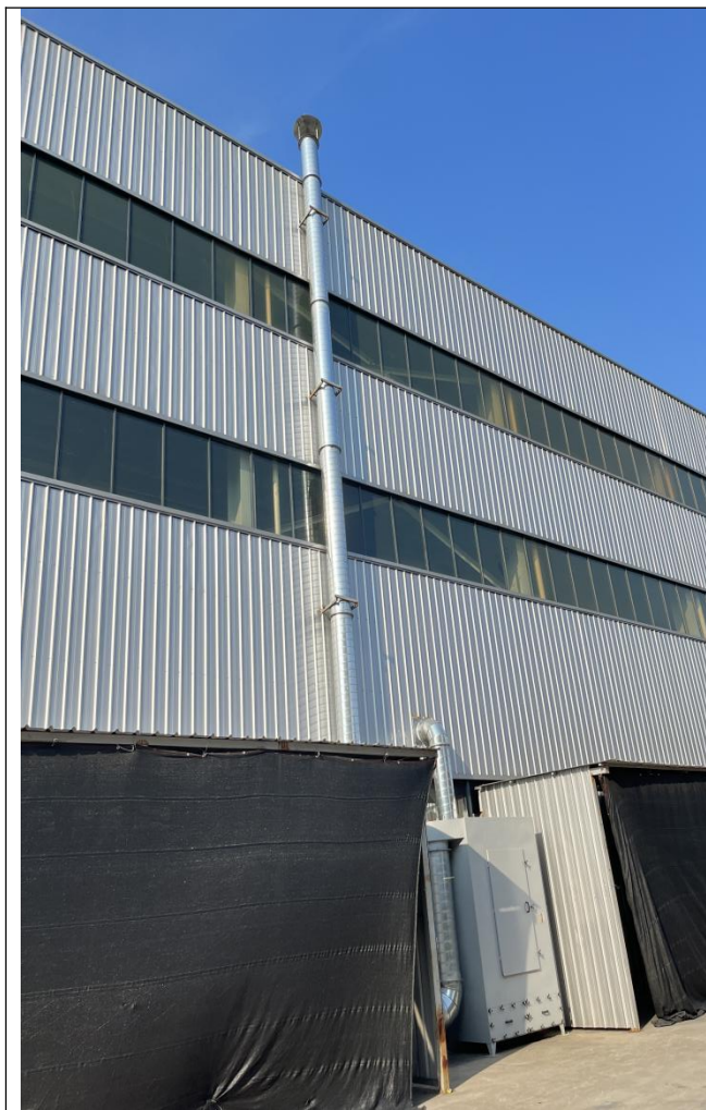
3#车间切割烟尘收集措施
